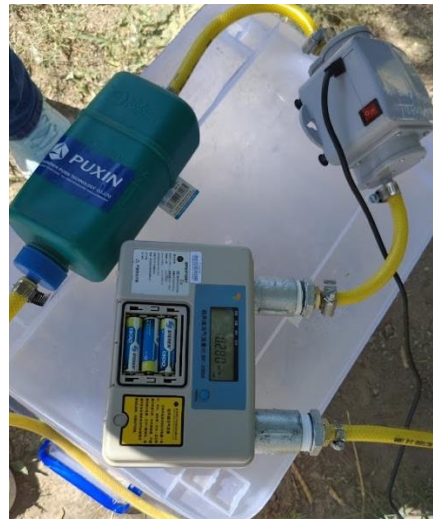
Figura 06. Purificación y monitoreo del biogás.
