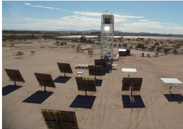
Figura 1. Fotografía del CEToC con 8 heliostatos en operación.
