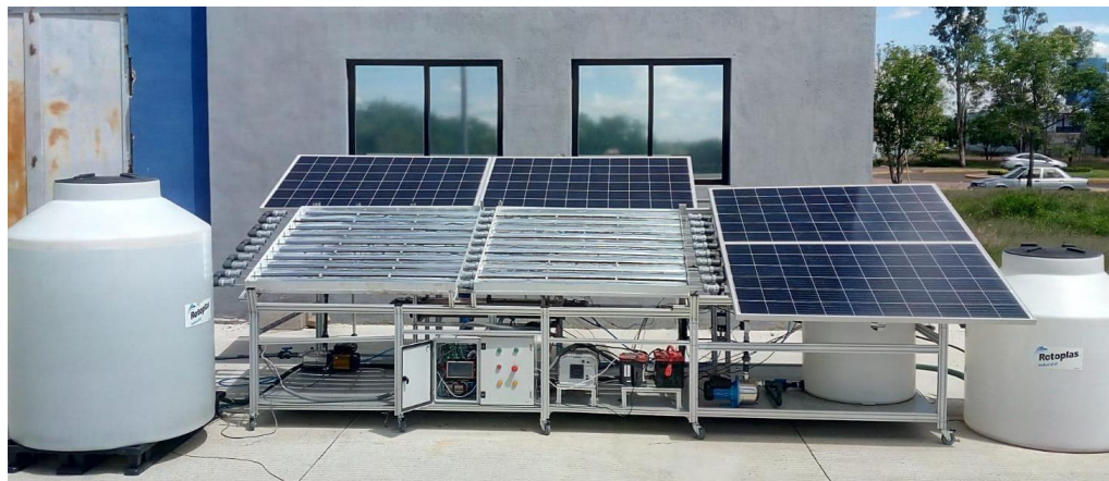
Figura 3.- Prototipo sistema potabilizador
