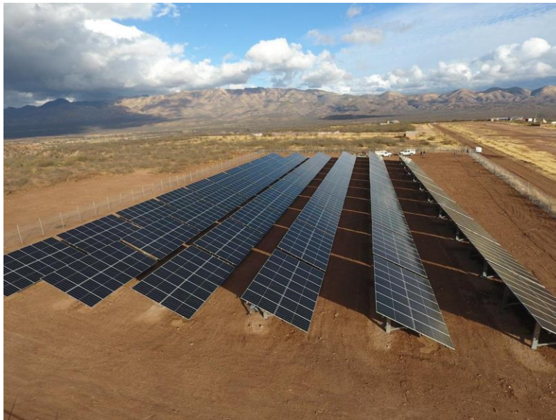
Figura 2. Planta fotovoltaica del municipio de Bacerac, Hermosillo, Sonora.
